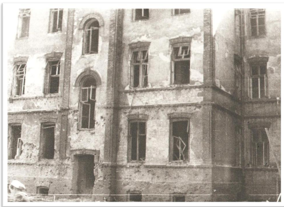
Ryc. 36 Wojenne zniszczenia Domu ks. Baudouina, ADMD
